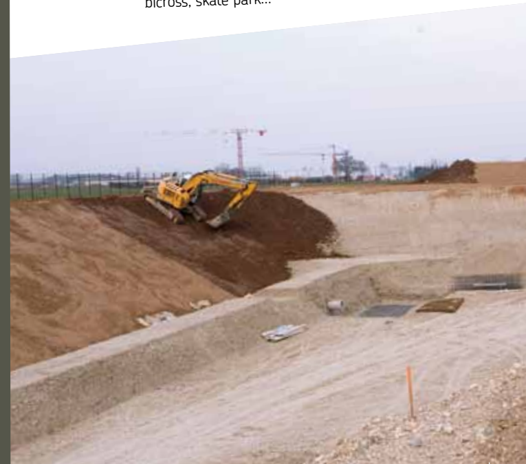
Bassin de rétention des eaux pluviales de Cadou.
